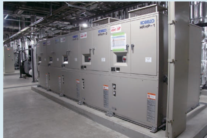
熱回収ヒートポンプ(高温ヒートポンプチャラー)
