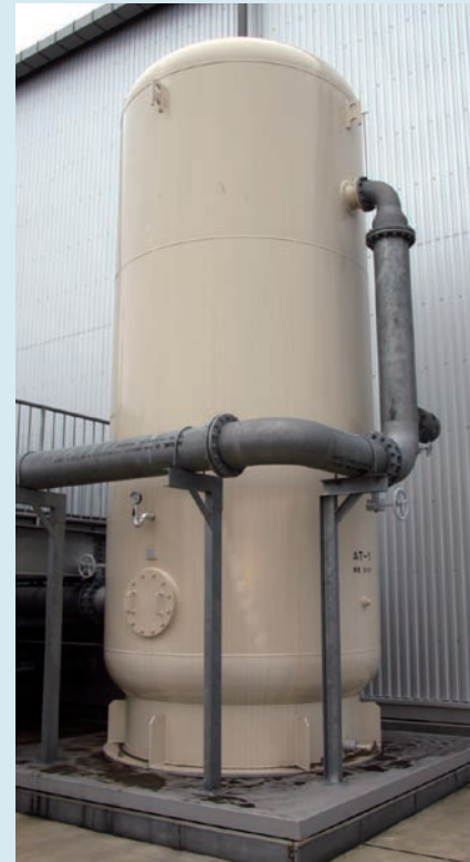
レシーバータンク ▲
