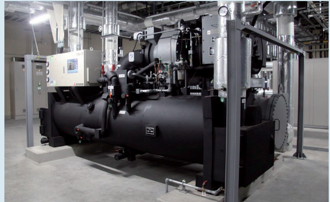
本システムの核となる熱回収ターボ冷凍機
