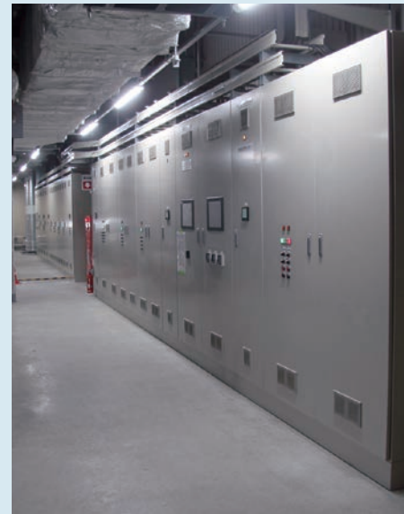
▲ 熱交換器の制御盤
