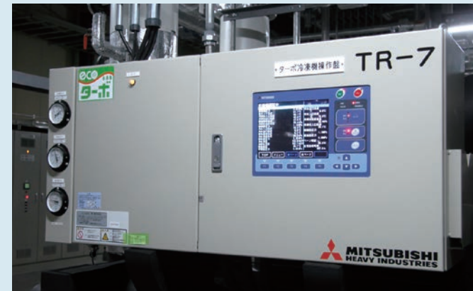
熱回収ターボ冷凍機の制御盤
