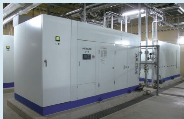
▲オイルフリー式スクルーコンプレッサー
